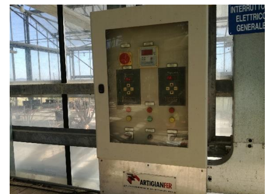
Quadro comando coperture
